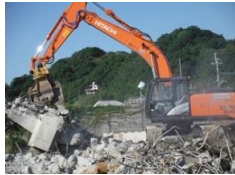
床板・梁2次破碎状況
