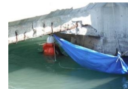
汚水収集状況
