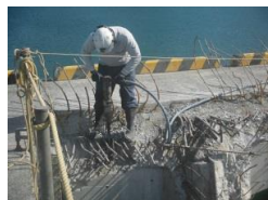
端部研り状況
