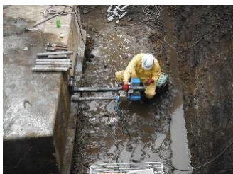
桁上床板破碎
